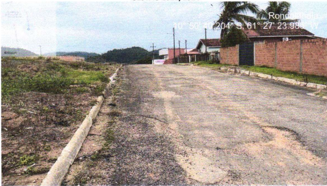
IMAGEM 29 – RUA PEDRO MOREIRA ENTRE (AV JOANA ALVES DE OLIVEIRA / RUA RIO MADEIRA)
