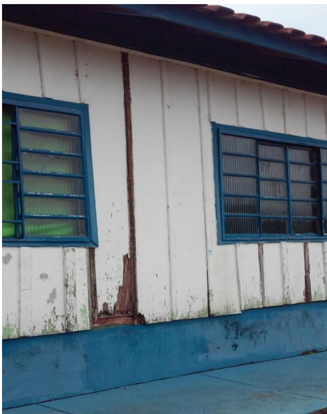
Imagem 04: Dano estrutural externo
