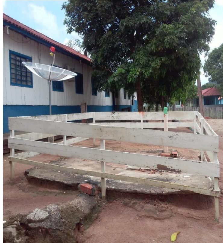
Imagem 11: Perímetro da fossa interditado
