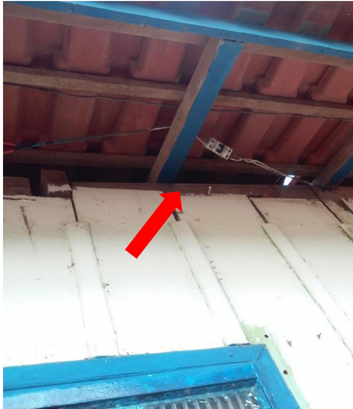
Imagem 07: Dispositivo de proteção desafixados/sem quadro
