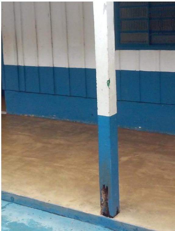
Imagem 02: Estrutura com dano total
