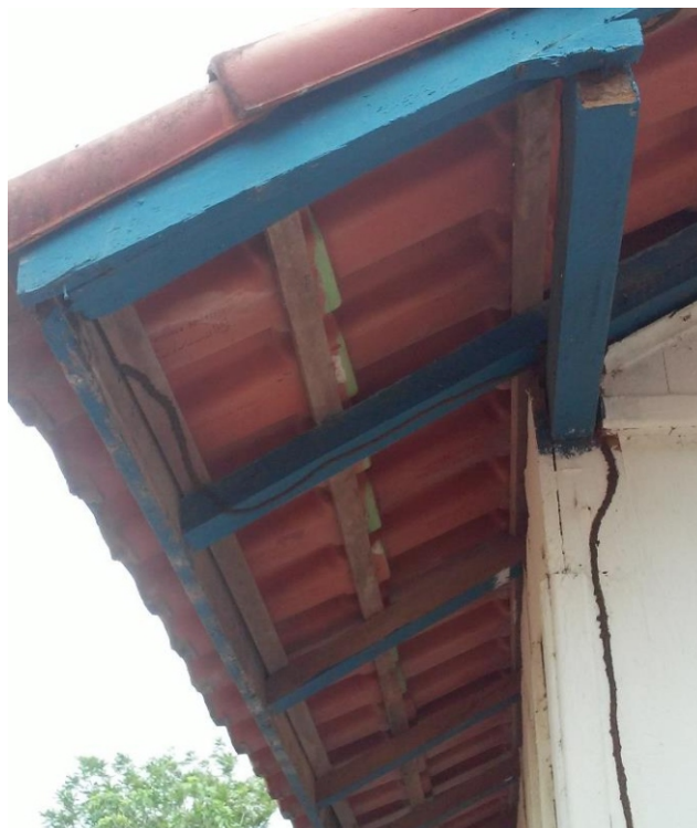
Imagem 03: Cupins em paredes e cobertura
