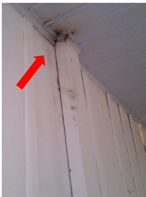
Imagem 09: Vestígios de curto circuito ocorrido
