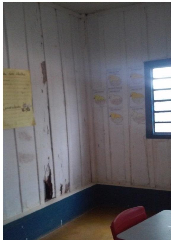
Imagem 05: Dano estrutural interno
