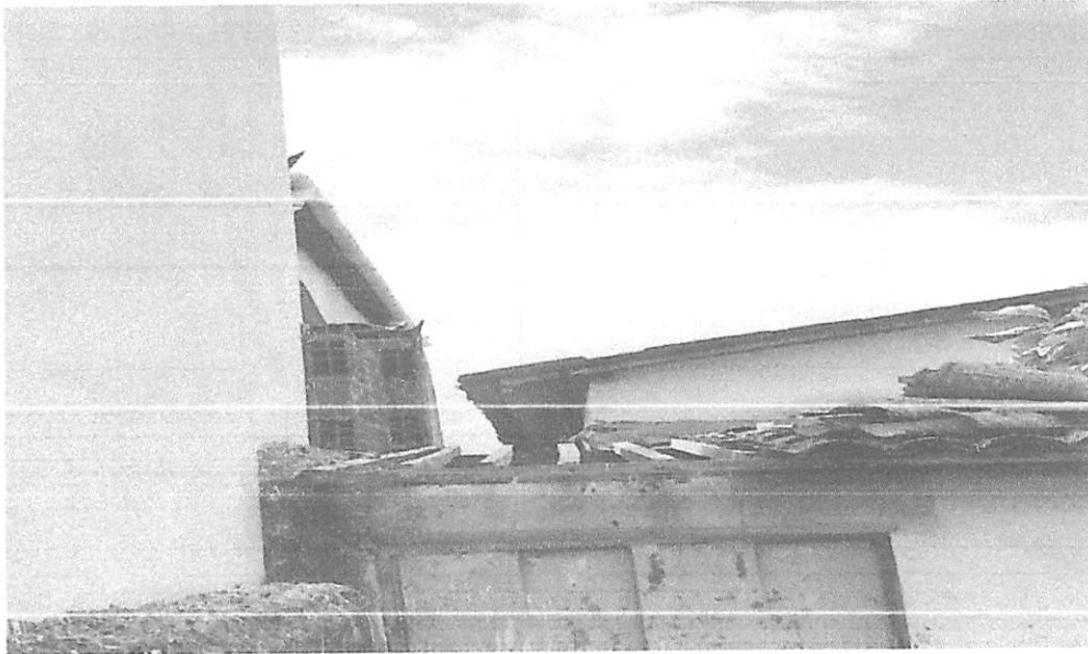
Foto 7 – Destelhamento irregular na residência da denunciante.
